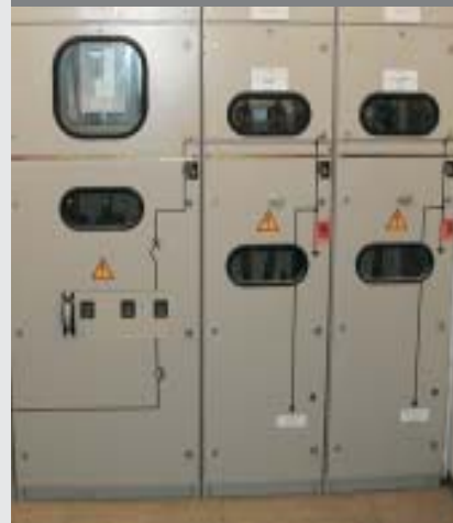
Schaltschrank im Stadttor Düsseldorf
